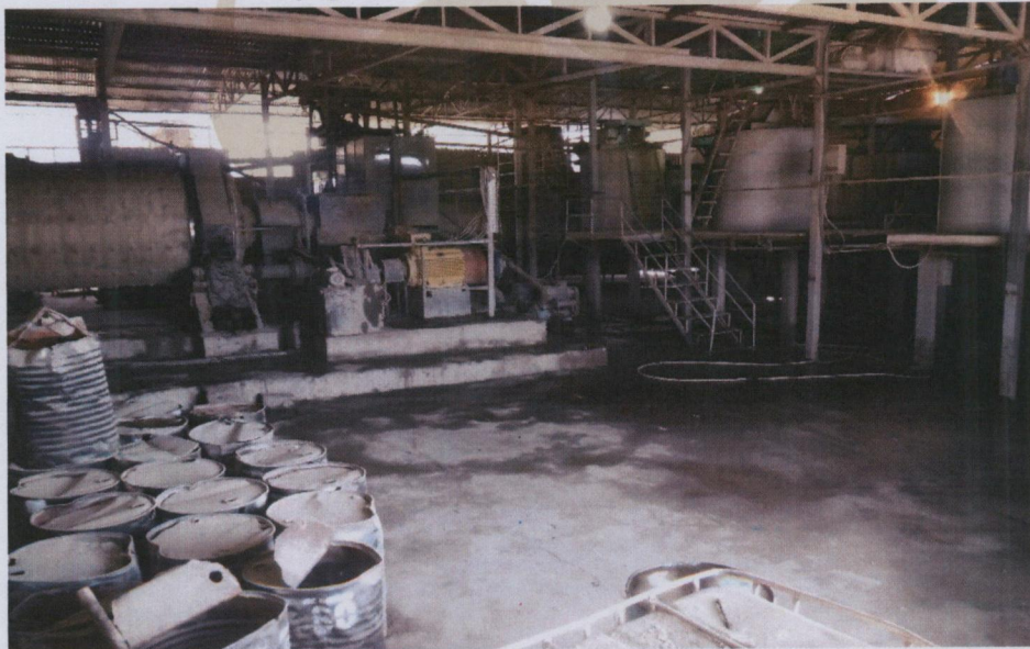
نمایی از کارخانه فلوتاسیون
